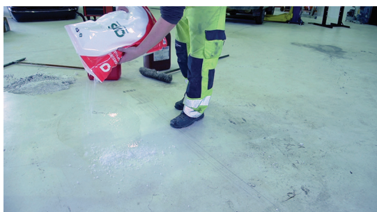
Bensiinivahingon poisto lattialta
